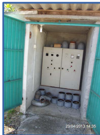
Imagem 8: Materiais depositados dentro da casa do quadro de comando do Poço 01.
