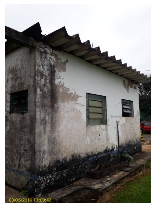
Foto 17 - Estrutura civil danificada
