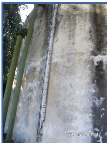
Imagem 34: Régua do reservatório R 01.
