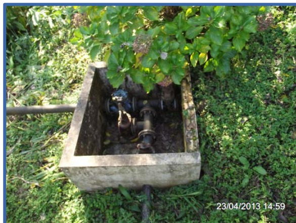
Imagem 11: Caixa dos registros de manobras da adutora de água bruta.
