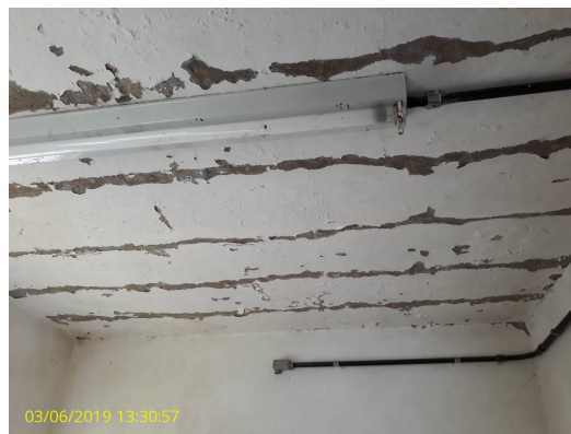
Foto 7 - Área interna em condições inadequadas de conservação
