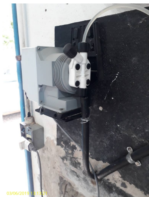
Foto 27 - Bomba dosadora de PAC
