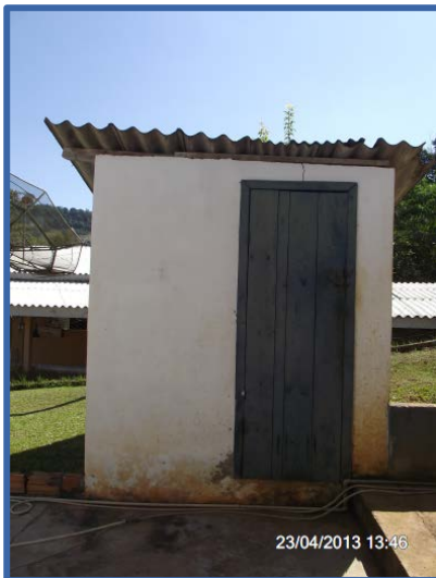
Imagem 20: Depósito de produtos químicos.
