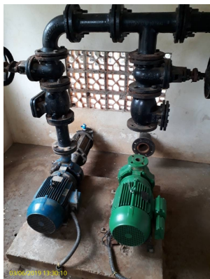
Foto 9 - Conjunto motobomba. Foi instalado bomba reserva nova
