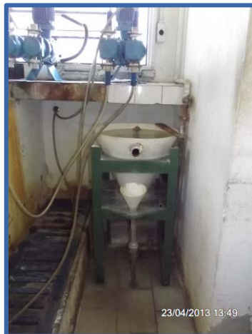
Imagem 37: Sistema de dosagem do flúor com tecnologia defasada.
