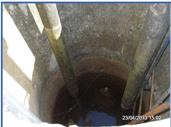
Imagem 10: Poço de sucção de água bruta.
