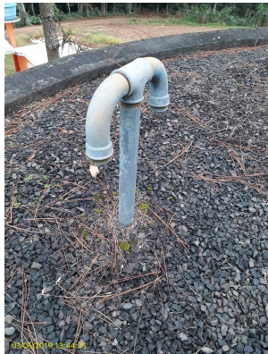
Foto 44 - Duto de ventilação
